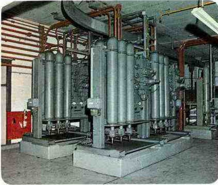
Аккумуляторная установка для снабжения установок наупера и доменной печи
